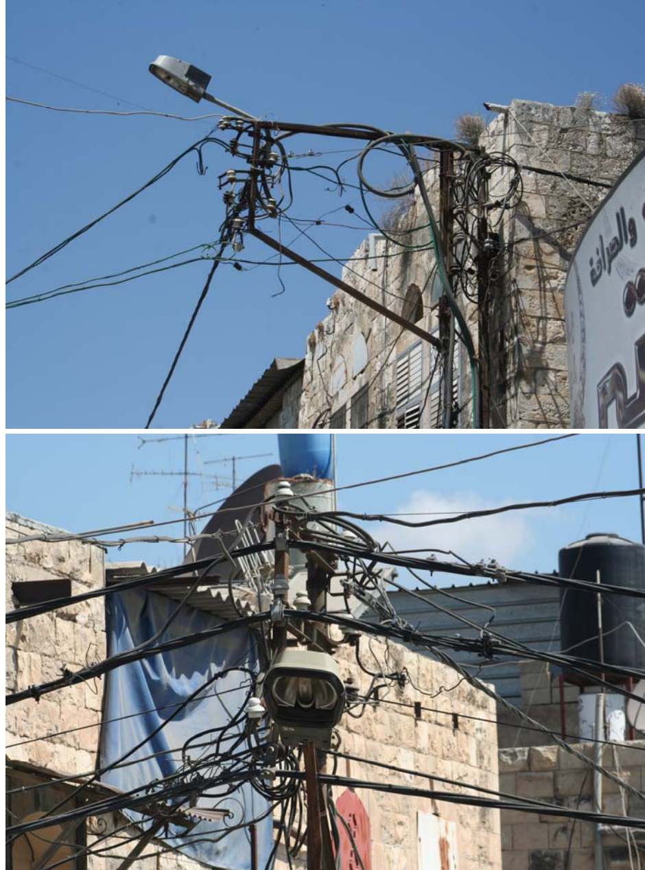
صورة (3): تشابك أسلاك أعمدة الإنارة في الشوارع
