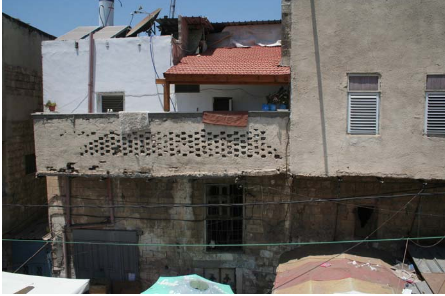
صورة (16): تردي وسوء واجهات المباني بسبب قلة الصيانة
