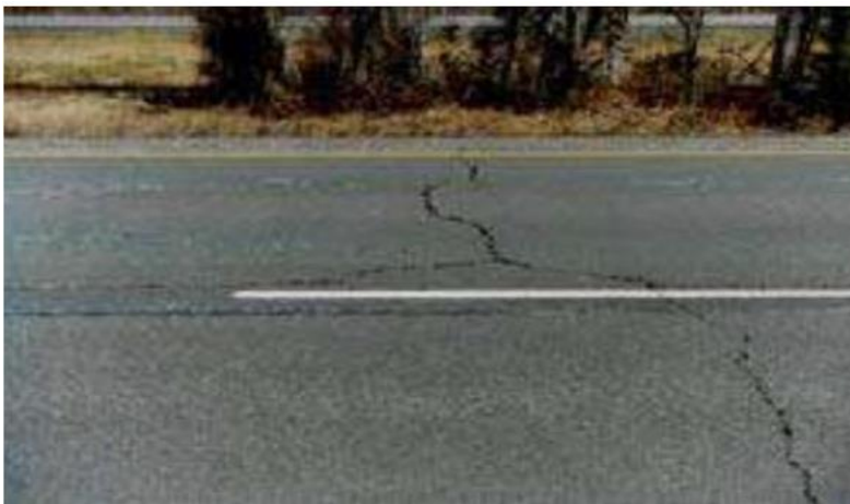
Figure 2.2: (d) Thermal cracking [90].
