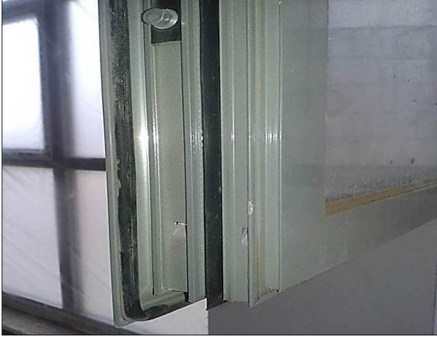
صورة: (4-23) شباك داخلي زجاج شفاف طبقة واحدة المستشفى التركي، غزة المصدر: تصوير الباحث .
