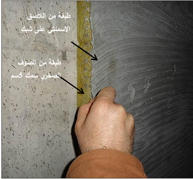
صورة: (4-39) مقطع في طبقات العزل قبل القصارة المصدر: الباحث . غزة . المستشفى التركي، غزة .
