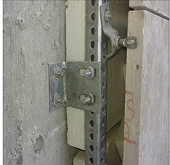
صورة: (4-11) اشكالية التقاء البروفيل مع حافة الشباك المصدر: تصوير الباحث - غزة
