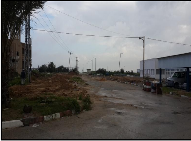
شكل (4-36): تضرر الشارع المؤدي
