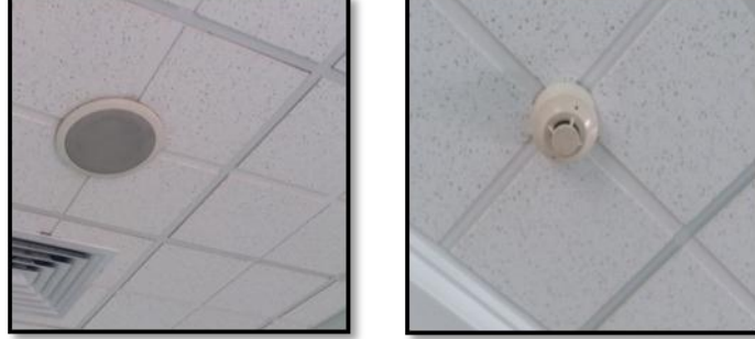
شكل (5.16): أنظمة انذار الحريق المستخدمة في المبنى
