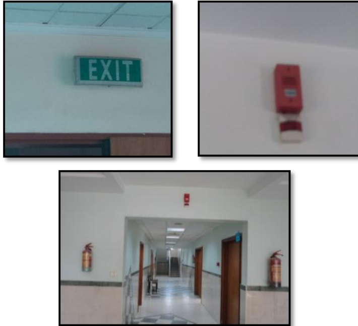
شكل (5.17): أنظمة انذار الحريق المستخدمة في المبنى
