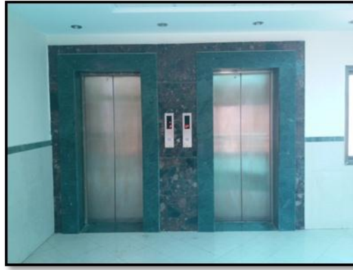
شكل (5.19): المصاعد المستخدمة في المبنى
