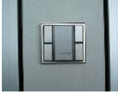
شكل (4.10): لوحة مفاتيح التحكم المستخدمة في المبنى
