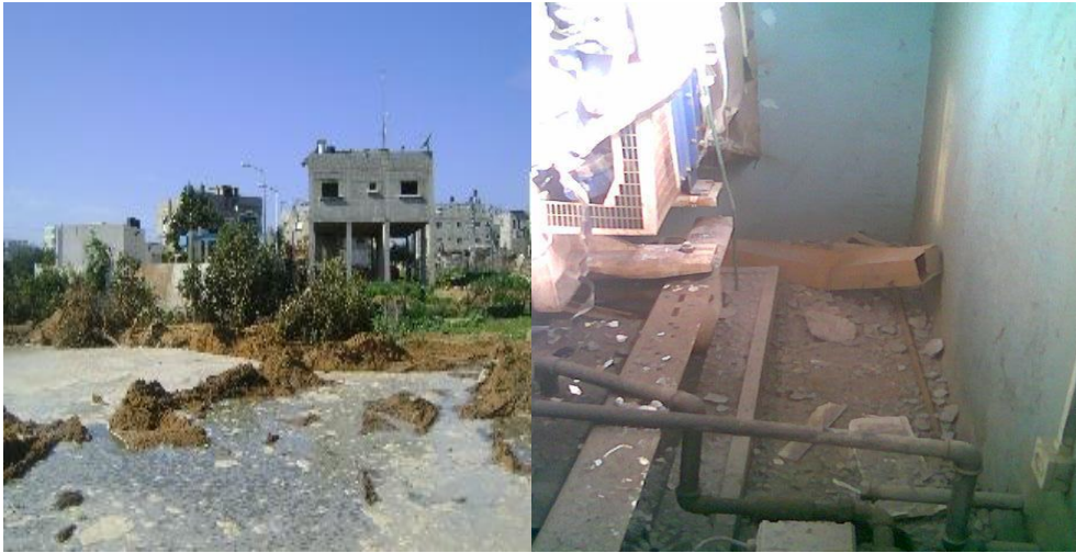
صورة (3.12) قصف صهيوني لمحطة مشروع بيت لاهيا صورة (3.13) تدفق مياه الصرف الصحي ببيت لاهيا
