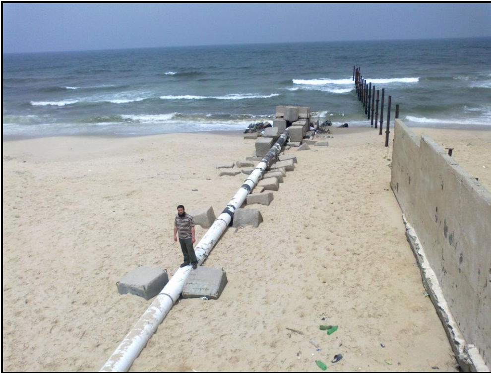
شكل (2-19) الخط الناقل لصرف المياه العادمة إلى مياه البحر المتوسط المصدر: زيارة ميدانية قام بها الطالب لمنطقة الدراسة بتاريخ 2012/5/1م.
