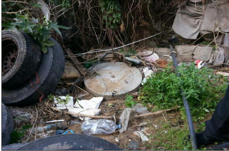
شكل (3-36) منظر لأحد الآبار المغذية للمحطة في إحدى مشاريع التحلية.
