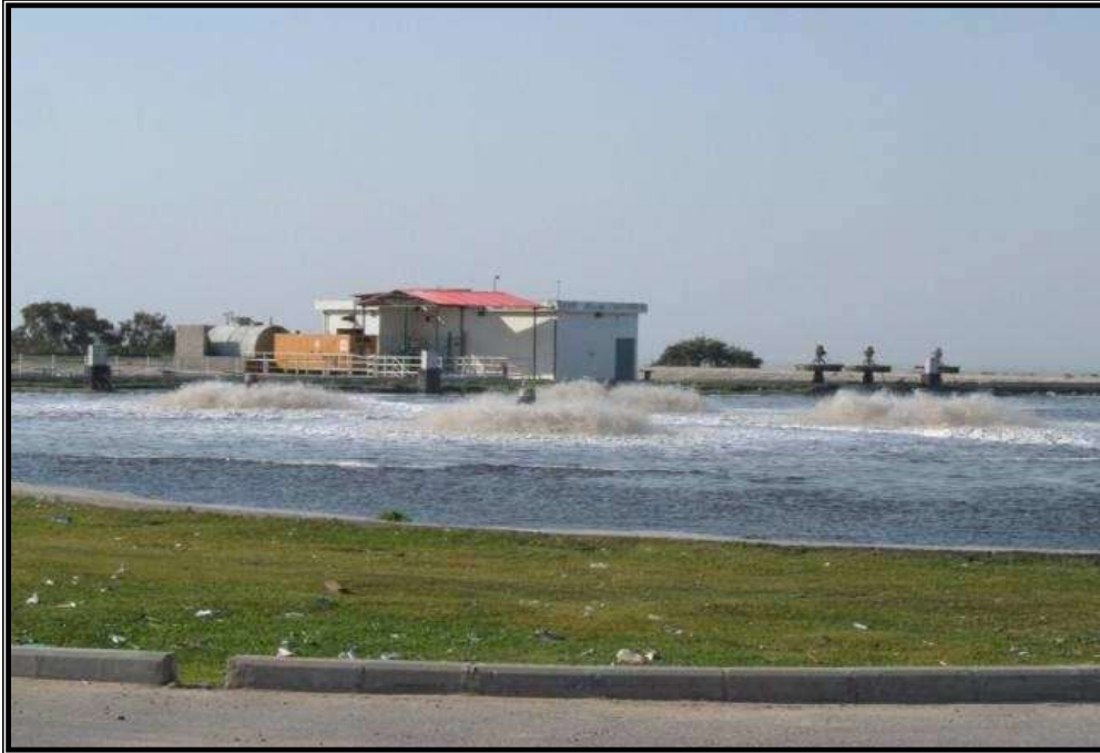
صورة (2-3) أحواض المعالجة الهوائية في محطة الشيخ عجلين.
