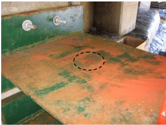
b. Top Web-Plate Cracking
