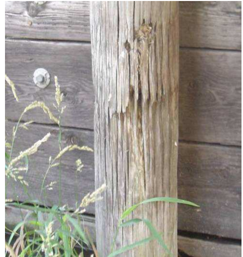
(b) Rotten pile
