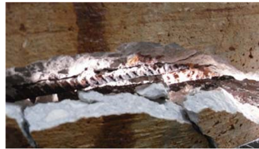
(d) concrete cover delamination
