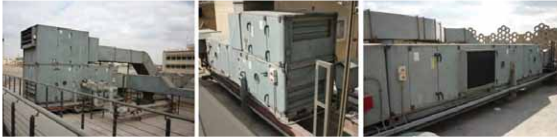
شكل ( 3-83): نظام التكييف الذي يعتمد على تبريد المياه Chilled-water Air Condition الموجود على سطح المبنى (المصدر: الباحث)
