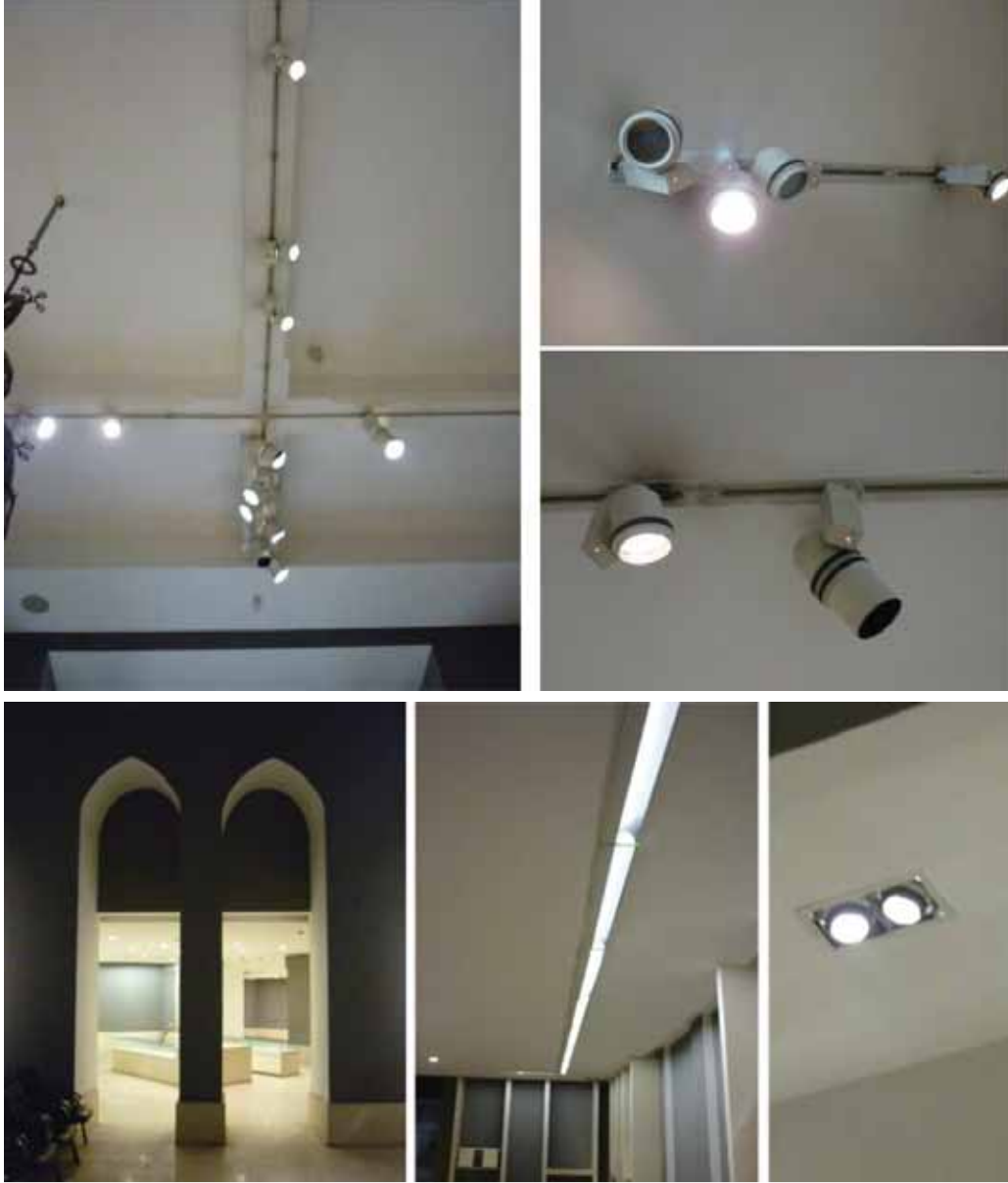
شكل ( ٣-٨٩): مجموعة من أشكال وأنواع وحدات الأضاءة المستخدمة في أنارة المبنى (المصدر: الباحث)
