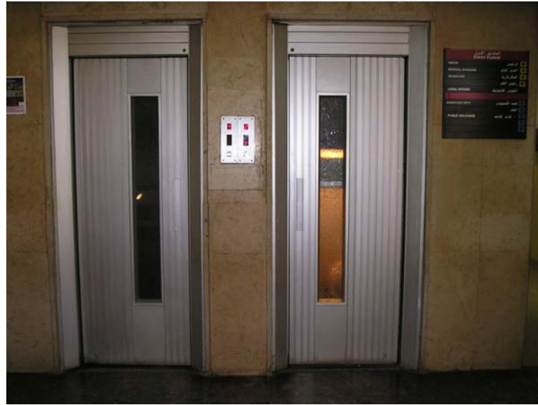
صعوبة استعمال المصعد الكهربائي في بلدية نابلس.
