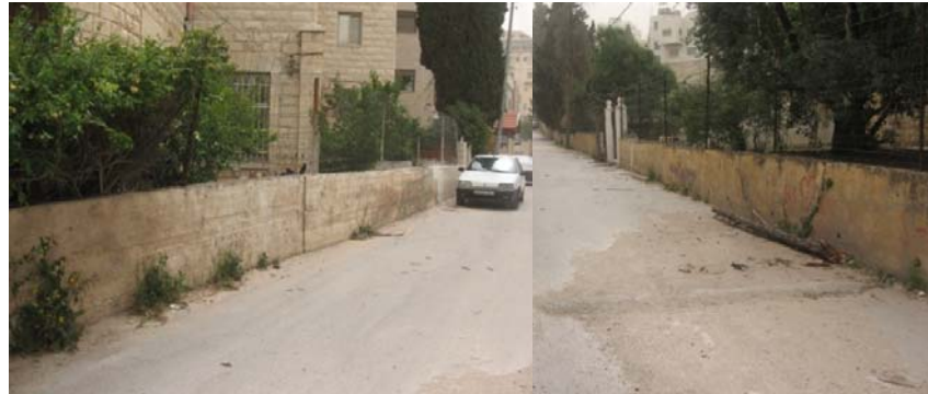
صورة (61): سور مبني من الإسمنت والمطلي بمادة طلاء فقط المصدر: الباحث.
