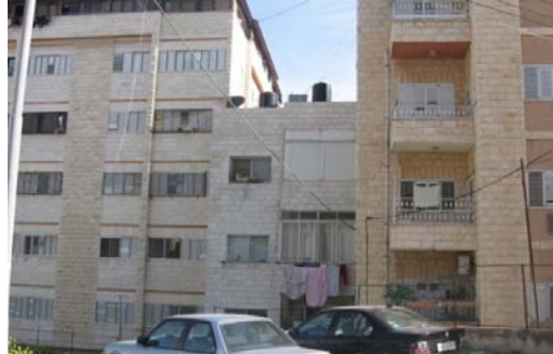
صورة (75): تشوه ناجم عن عدم وضع محددات تخطيطية تعنى بالمحيط للمادة 37 من النظام من حيث الشكل الخارجي والإرتفاع والفتحات المصدر: الباحث.
