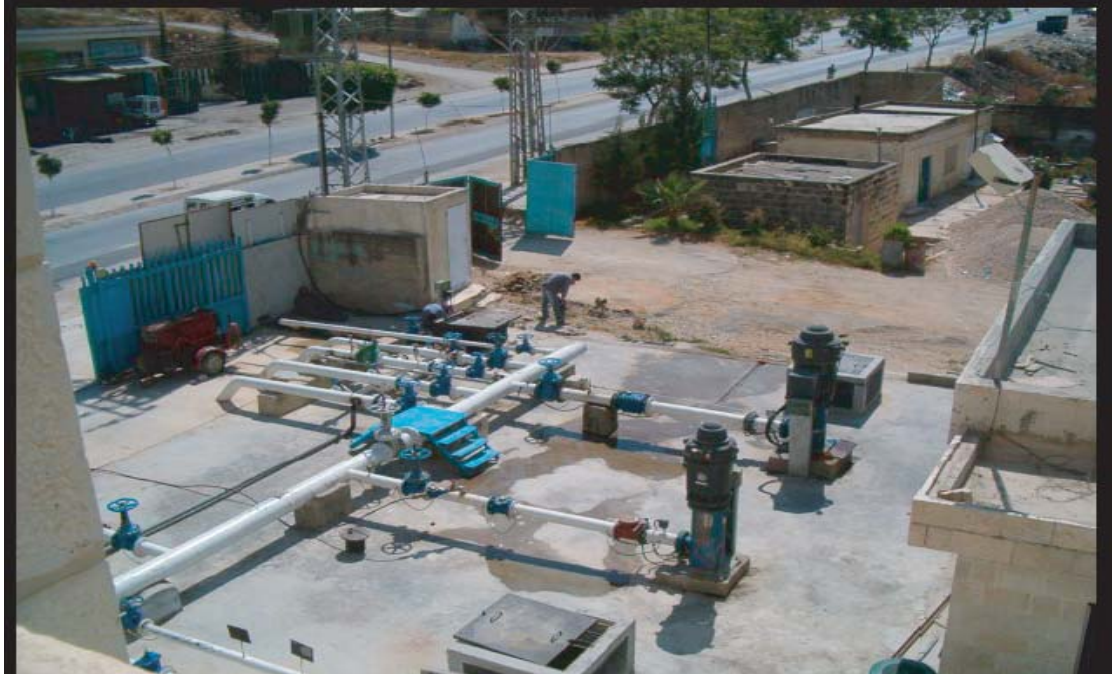
Ein Beit Elma Pumping Station , and Reservoir
