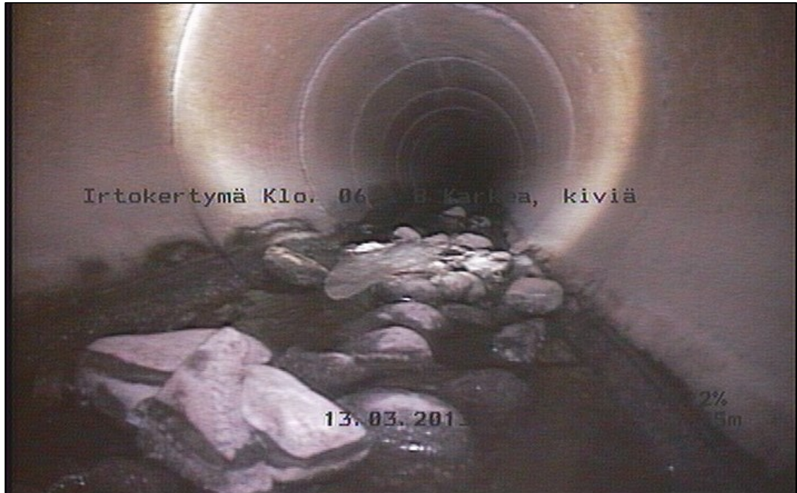
Kuva 8. Viemäriputki kuvattuna ennen saneerausta. Viemäriputkeen kertyneitä kiviä, jotka haittaavat viemärin toimintaa. (Simola 2013)
