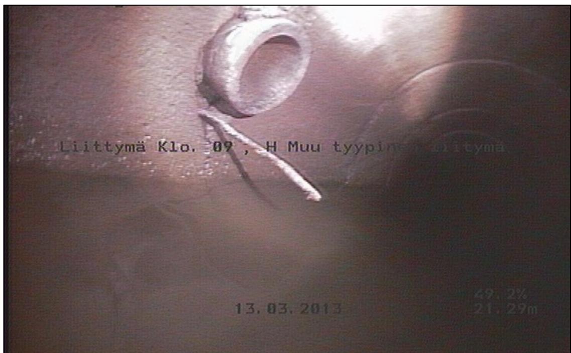
Kuva 11. Viemäriputkessa virheellinen putkiliittäminen. (Simola 2013)
