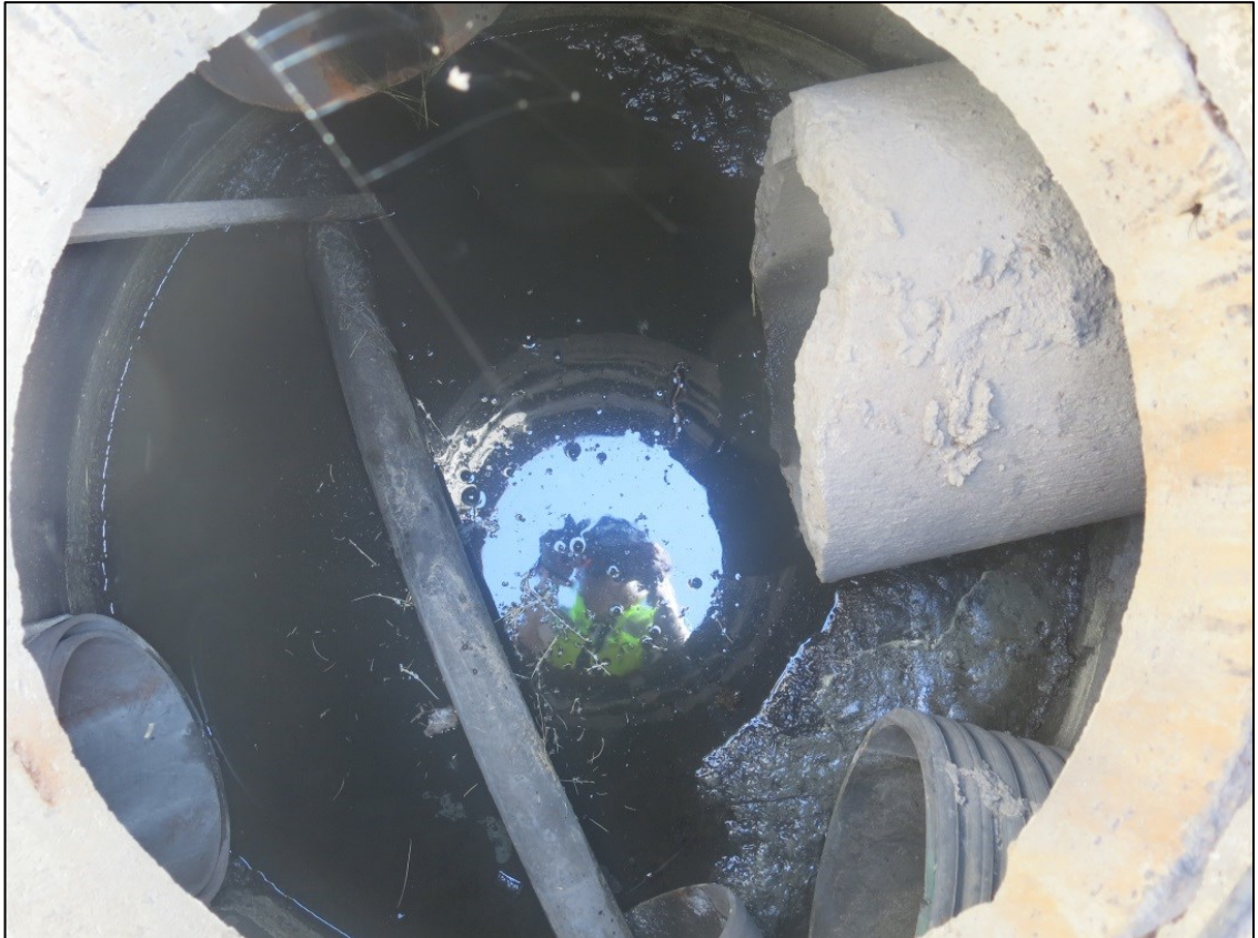
Kuva 6. Viemärikaivossa virheellisiä liittymiä. (Ronkainen 2014)
