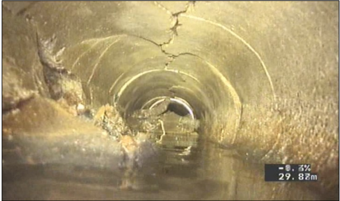
Kuva 5. Viemäriputki kuvattuna ennen saneerausta. Viemärin yläosassa on pituussuuntaista verkko- khalkeamaa. Putken yläpuolinen kuormitus on painanut putken vaakasuuntaan soikeaksi, ja put- ken seinämistä on irronnut palasia putken sisälle. (Hyvärinen 2016)
