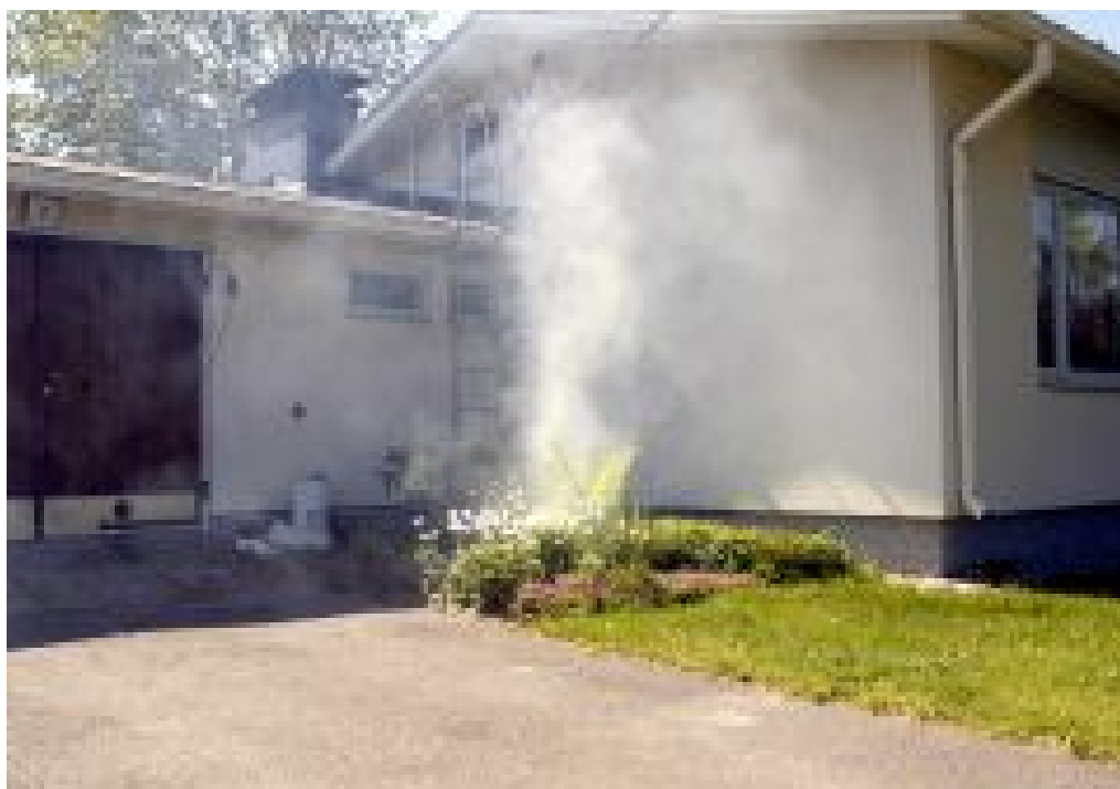
Kuva 2. Savu nousee jätevesiputken tarkastusputkesta niin kuin pitääkin. Mikäli hulevesiliitos olisi tehty väärin, nousisi savu sadevesirännin alla olevasta rännikaivosta. (TS-Yhtymä Oy 2004).
