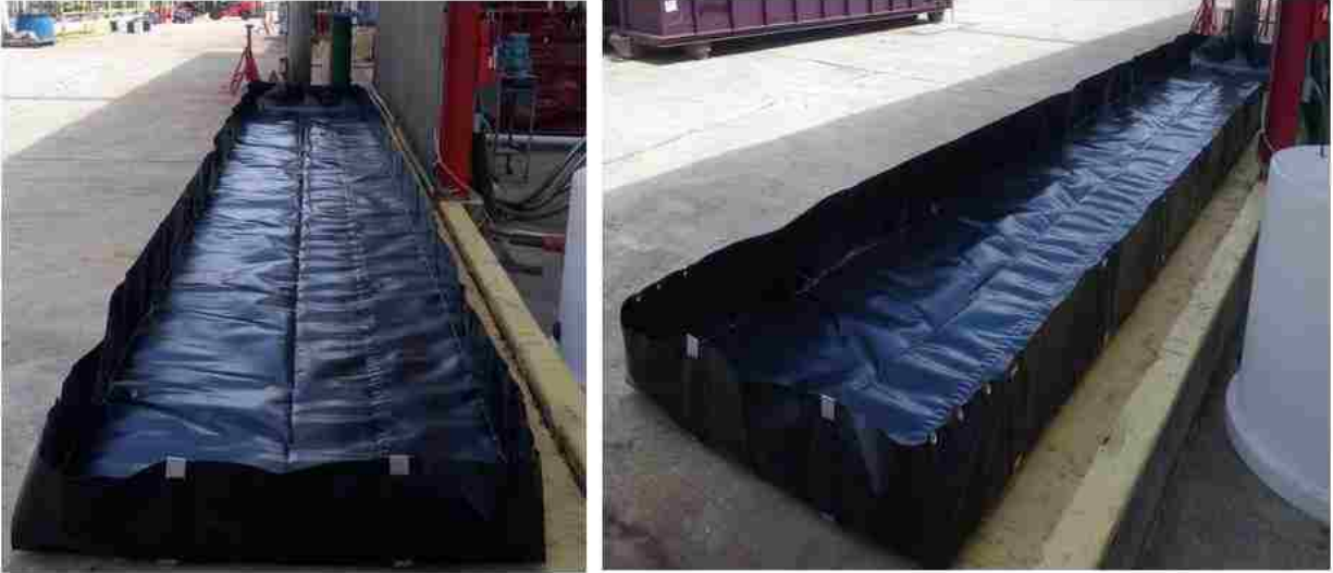
Fig. 19. Geomembrane for spill containment
