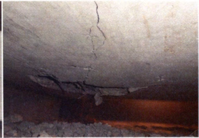
(d) Spalling on Tension Face
