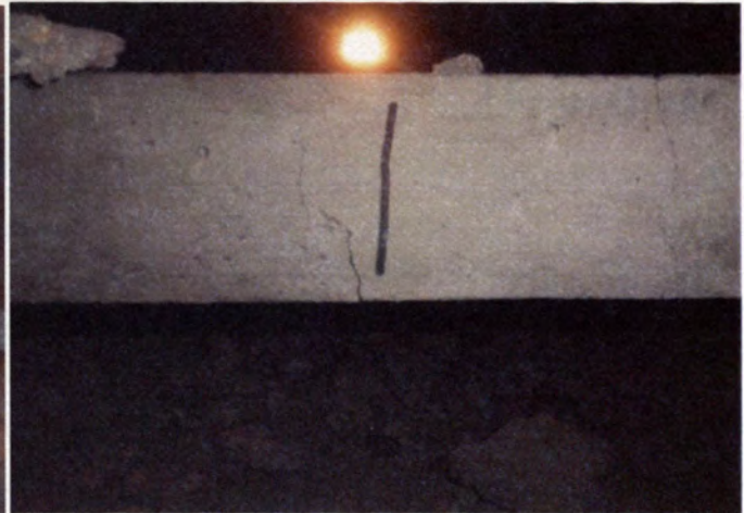
(d) Flexural Cracks in the Back Face
