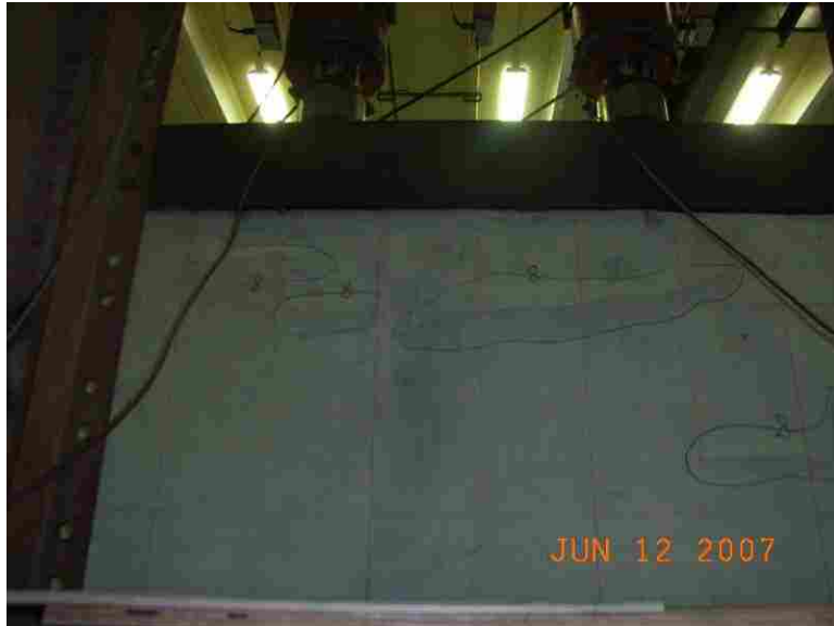
Bubbling of Structure Coat (wall #9)
